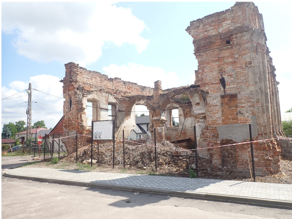
FOT. 3 Elewacja zachodnia - mury elewacji zawalone, zdewastowane
