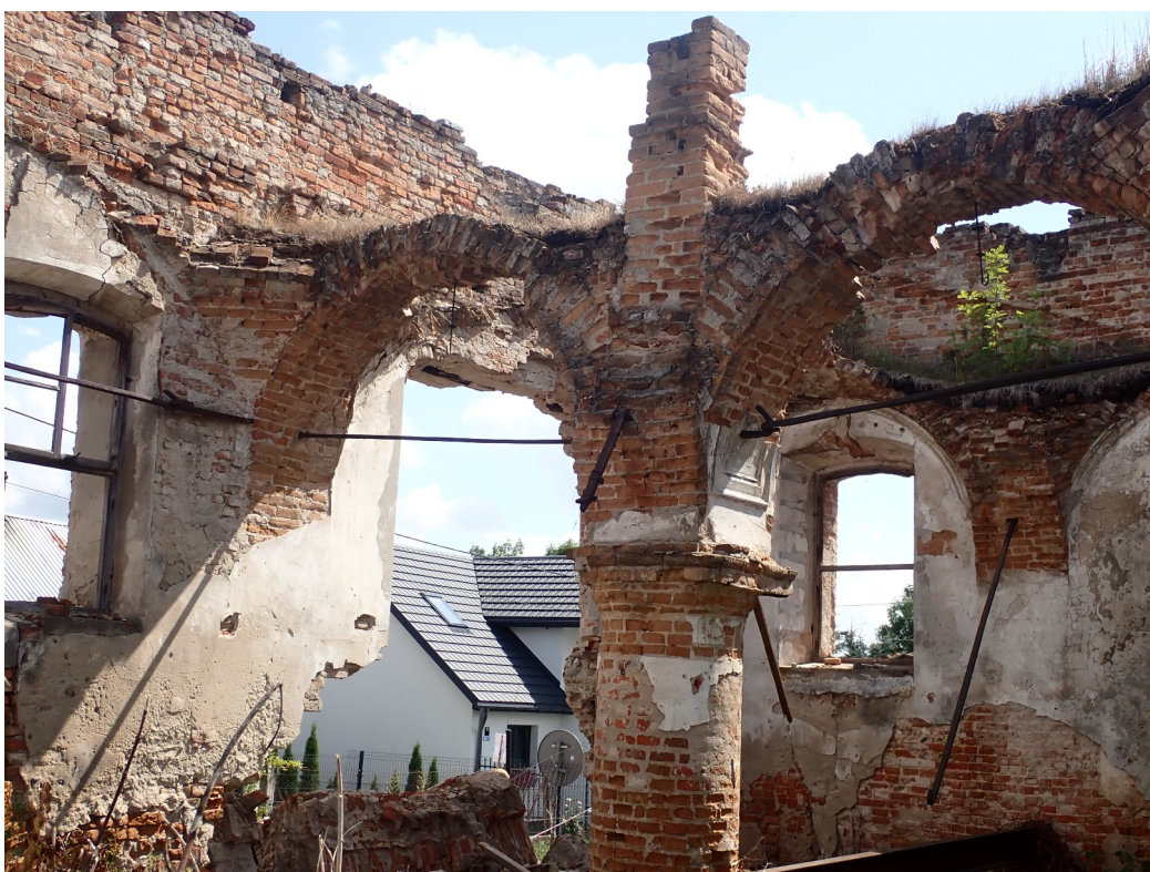
FOT. 7 Wnętrze Zachowane arkady podziału wnętrza obiektu, relikty łęków, mchy i porosty. Stan techniczny grożący zawaleniem
