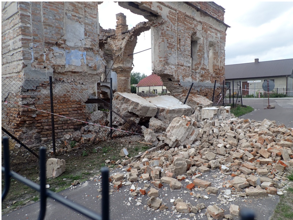
FOT. 5 Elewacja północna- fragment zawalonej ściany (rozległa wyrwa), na ulicy zalegający gruz ceglany, krawędzie wyrwy są nieustabilizowane, przyległe partie muru pozbawione pierwotnego oparcia. Mocne spękania pionowe i ukośne.
