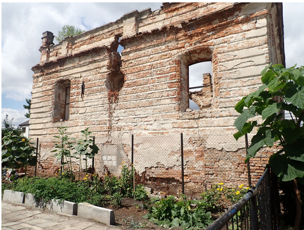
FOT. 6 Elewacja Wschodnia - najlepszy stan zachowania Spękania pionowe i ukośne, korona muru pozbawiona zabezpieczenia
