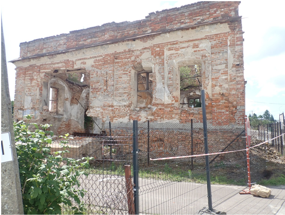
FOT. 4 Elewacja Północna, Silne spękania pionowe i ukośne, korona muru pozbawiona zabezpieczenia
